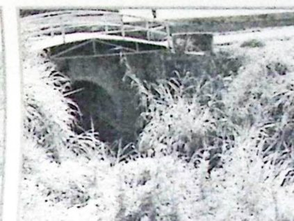
Sujeira em que se encontra as margens do córrego, ao lado da rodoviária
