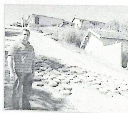
Vereador "Juninho Coelho" ao lado de uma das ruas do Bairro Tiro aos Pombos que necessitam ser reparadas.
