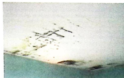
Sala de atendimento com umidade e embolorada
