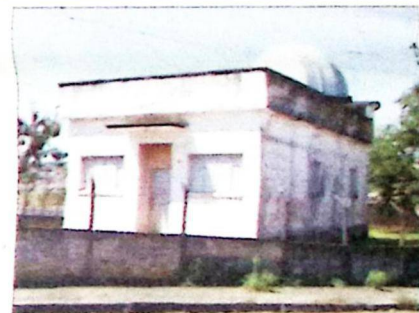
Foto atual do Observatório Centauro, que necessita de reparos urgentes.
